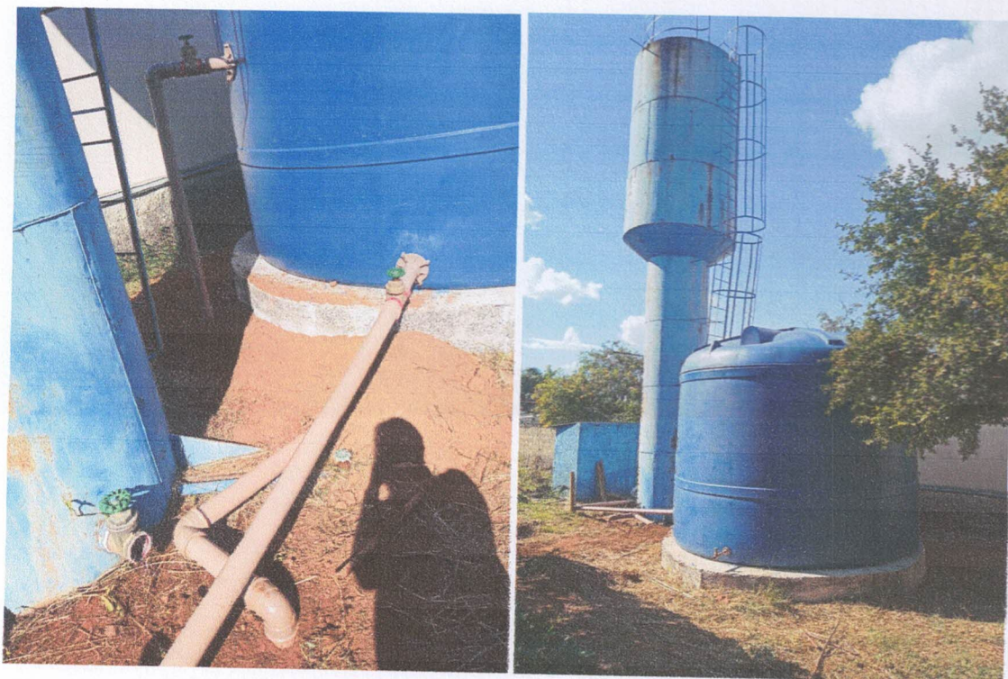
Instalação da nova caixa d'água do Abrigo Provisório e Casa de Passagem.
